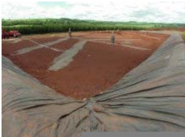
Foto1: Sistema de drenagem horizontal(2002)
