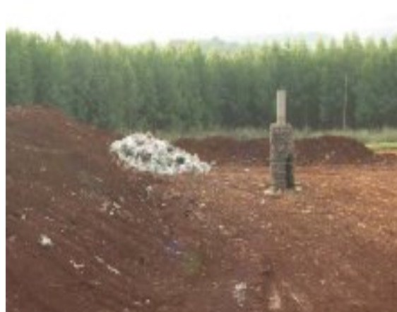
Foto 2: Sistema de drenagem vertical (2002)
